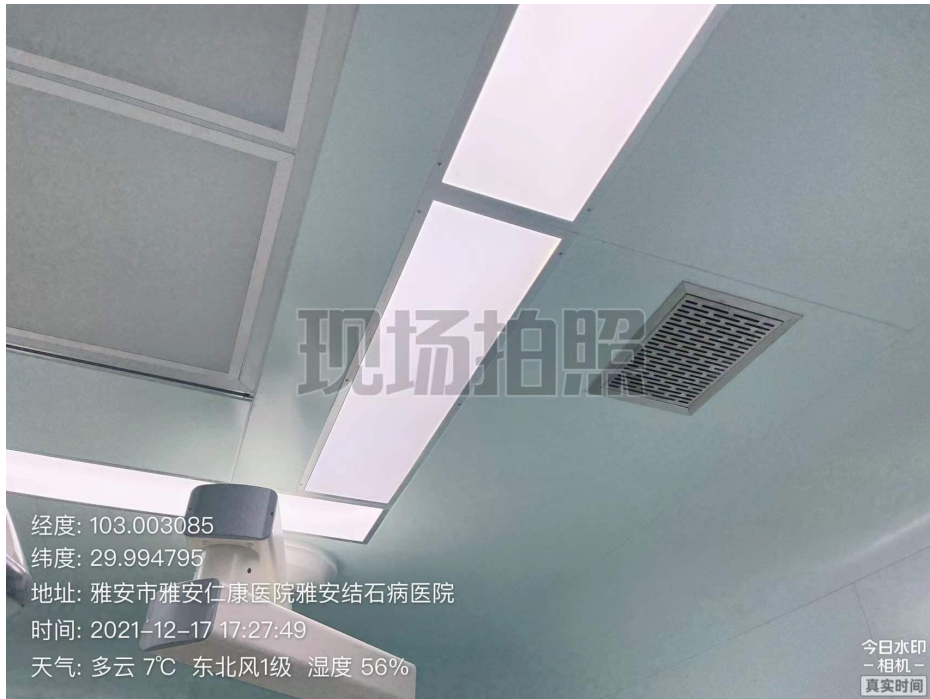
图 4-9 手术室 5 内通排风系统
