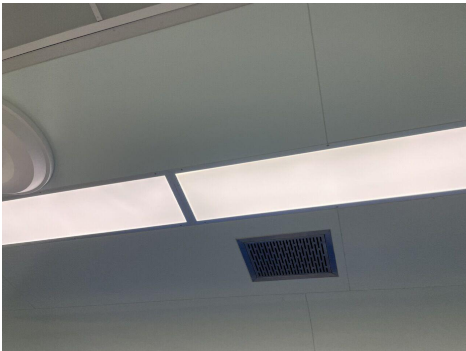
图 4-10 手术室 6 内通排风系统
